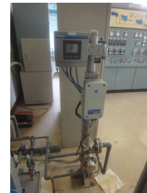
写真3 pH計設置状況(現況)
