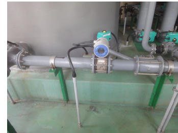
写真1 電磁流量計100A設置状況(現況)
