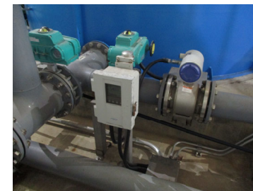
写真2 電磁流量計150A設置状況(現況)
