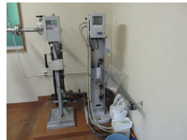
※写真5 無試験形遊離塩素計設置状況（現況）
