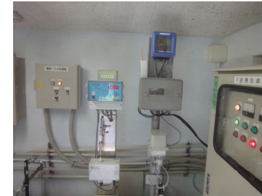
写真4 濁度計設置状況(現況)
